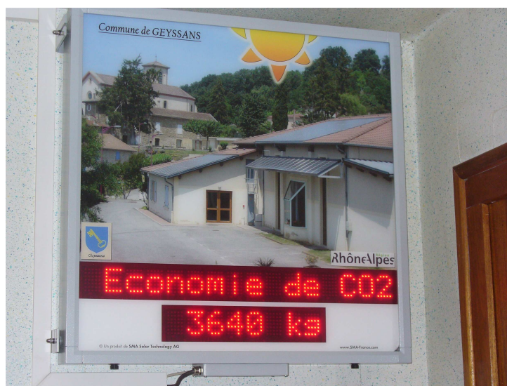
Les performances énergétiques sont retranscrites sur ce panneau installé dans l'entrée de la salle polyvalente
